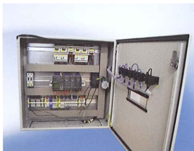
Schaltschrank innen mit Micro-SPS
